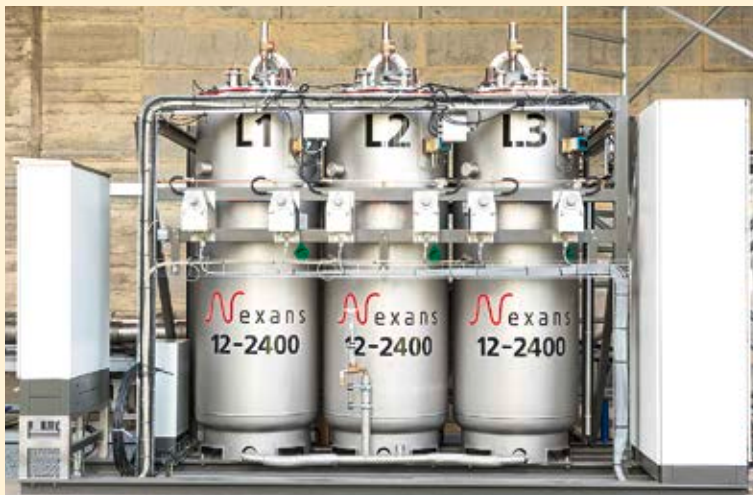
Abb. 4 Die Strombegrenzer der drei Phasen befinden sich in separaten Kryobehältern.
