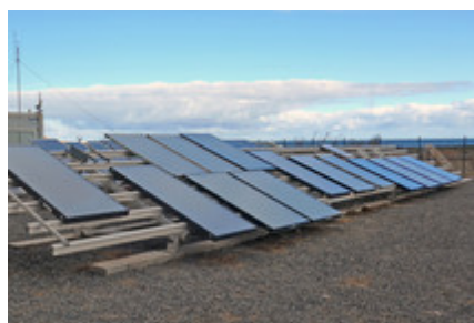
Maritimer Teststand in Meeresnähe: Die Abbildung zeigt das Kollektortestfeld bei Pozo Izquierdo auf Gran Canaria. © Fraunhofer ISE
