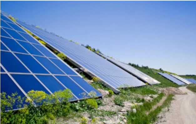
Die thermische Solaranlage Hirtenwiesen II in Crailsheim hat eine Kollektorfläche von rund 7.400 Quadratmetern. © Anna Durst, BINE Informationsdienst
