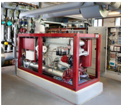
Blockheizkraftwerke nutzen Energie besonders effizient, weil sie in einem Prozess Strom und Wärme erzeugen. Im Zuge der Energiewende soll sich ihr Beitrag zur Stromversorgung in Deutschland bis 2020 verdoppeln.
