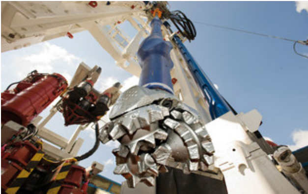
Auf dem Versuchsfeld Horstberg Z1 in der Nähe von Uelzen erprobt die BGR ein Konzept zur geothermischen Erschließung von Sedimentgesteinen im Norddeutschen Becken. © BGR (Symbolbild)
