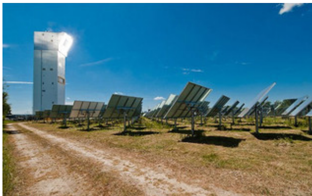
In der Pilotanlage Jülich lenken 2.153 bewegliche Spiegel (Heliostate) die Sonnenstrahlen auf die Spitze des 60 Meter hohen Turms. Dort werden die Strahlen von einem 22 Quadratmeter großen Receiver aufgenommen und in Wärme umgewandelt.
