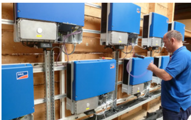
Die Wechselrichter-Einrichtung beim mittelständischen Unternehmen Franz Xaver Denk: Einer von mehreren Feldtests wird hier im Forschungsprojekt PV-Integrated durchgeführt. © SMA Solar Technology
