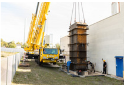
Angekommen am Heizkraftwerk Wellesweiler. Der Testbetrieb soll im Frühjahr 2019 starten. © DLR/Schreiner (CC-BY 3.0)
