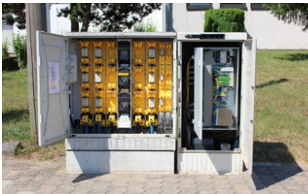
Netzsensorik in den Ortsnetzstationen und Kabelverteilern erfasst alle relevanten Qualitätsparameter. Die Datenübertragung erfolgt über das dedizierte Glasfasernetz oder GPRS.
