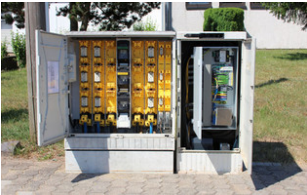
Netzsensorik in den Ortsnetzstationen und Kabelverteilern erfasst alle relevanten Qualitätsparameter. Die Datenübertragung erfolgt über das dedizierte Glasfasernetz oder GPRS. © Stadtwerke Saarlouis GmbH
