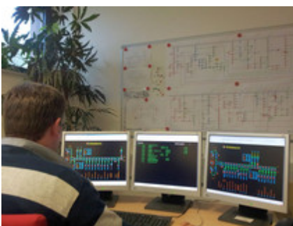
Eine zentrale Leitstelle ist mit den Holon-Steuerungselementen verbunden. © Stadtwerke Saarlouis GmbH
