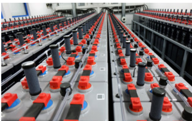
Der Batteriegroßspeicher M5 BAT in Aachen kann bis zu 10.000 Haushalte für eine Stunde mit Strom versorgen. Er ist eines der Highlight-Projekte 2017.
