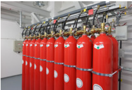
Sicherheit wird groß geschrieben: Zum Schutz der Lithium-Ionen-Akkus werden bei einem Brand die Batterieräume mit Argon geflutet. © Franz Meyer, BINE Informationsdienst
