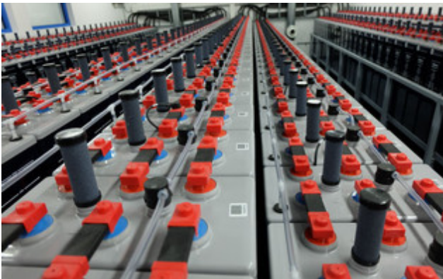
Die verwendeten Blei-Säure-Batterien sind aufgrund des Kupfergitters der negativen Elektrode besonders leistungsstark. Ein ökologischer Vorteil der Technologie ist eine Recyclingquote von mehr als 99%. © Franz Meyer, BINE Informationsdienst
