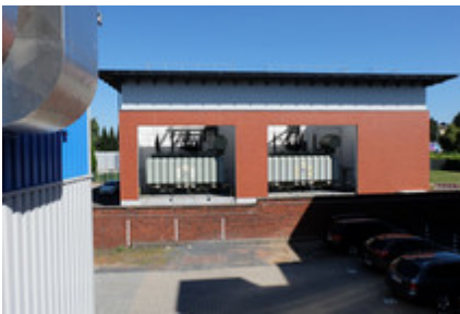
Das Umspannwerk befindet sich unmittelbar neben dem Batteriespeicher. © Franz Meyer, BINE Informationsdienst
