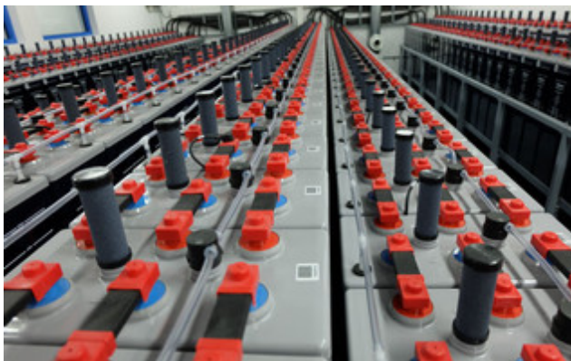
Die verwendeten Blei-Säure-Batterien sind aufgrund des Kupfergitters der negativen Elektrode besonders leistungsstark. Ein ökologischer Vorteil der Technologie ist eine Recyclingquote von mehr als 99%. © Franz Meyer, BINE Informationsdienst
