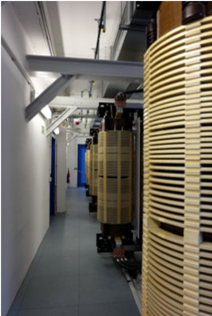
Mittelspannungstransformatoren verbinden den Batteriespeicher mit dem Netz. © Franz Meyer, BINE Informationsdienst
