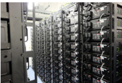
Lithium-Ionen-Akkus übernehmen die kurzfristige Leistungsspeicherung. © Franz Meyer, BINE Informationsdienst
