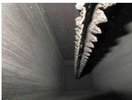
Innenansicht der Abscheiderbox, an den Elektroden ist der abgeschiedene Feinstaub erkennbar. © IZES
