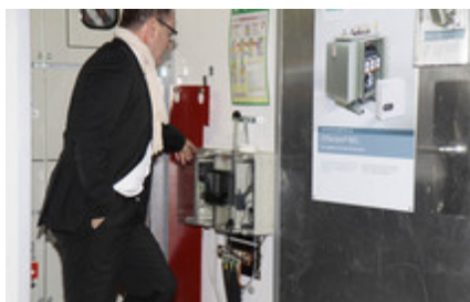
Bernhard Rindt von egrid vor der aktiven Netzstation, in der auch ein regelbarer Ortsnetztrafo für eine möglichst große Integration von erneuerbaren Energien sorgt. © Andreas Michels | BINE Informationsdienst
