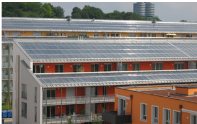
Neues Stadtquartier „Am Ackermannbogen“ in München mit solar unterstütztem Nahwärmesystem: Die Kollektoren sind im Mittel um 18,5° geneigt und leicht nach Südosten ausgerichtet. © Welter, Stadt München
