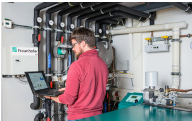
Im SmartEnergyLab des Fraunhofer ISE wurde die intelligente Betriebsführung auf Basis flexibler Tarife zunächst in einem ein Test-Aufbau erprobt. © Fraunhofer ISE
