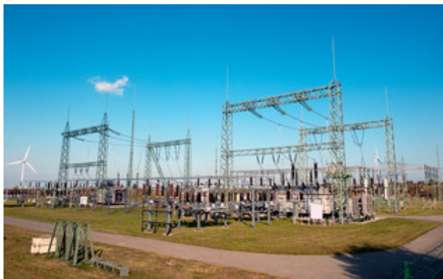
Energienetze benötigen eine umfassende Datenkommunikation, bei der Sicherheit eine zentrale Rolle spielt. Umspannwerk Bertikow in der Uckermark (Brandenburg) © 50Hertz
