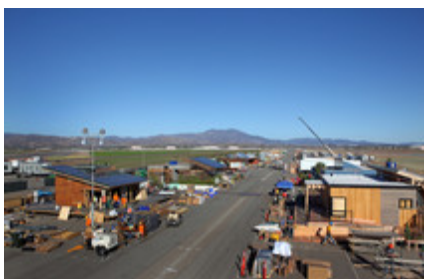
Ein bisschen wie auf einer Mondbasis: Die Teilnehmer errichteten ihre Gebäudeprototypen auf dem Rollfeld einer ehemaligen Militärbasis im kalifornischen Irvine.
