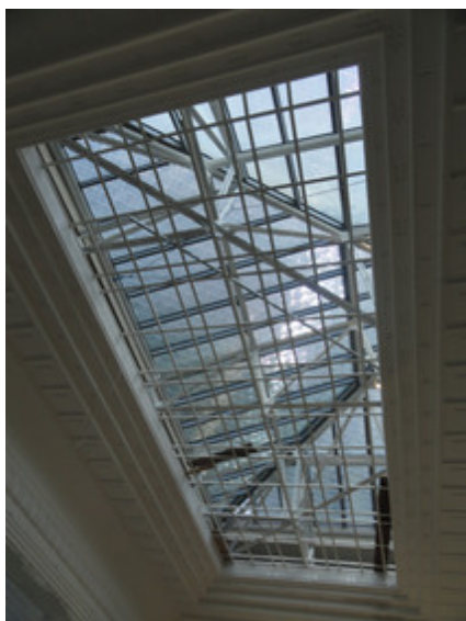
Durch den Einbau einer Spiegelrasterverglasung lässt sich das Tageslicht wieder nutzen, ohne dass der Raum überhitzt.
