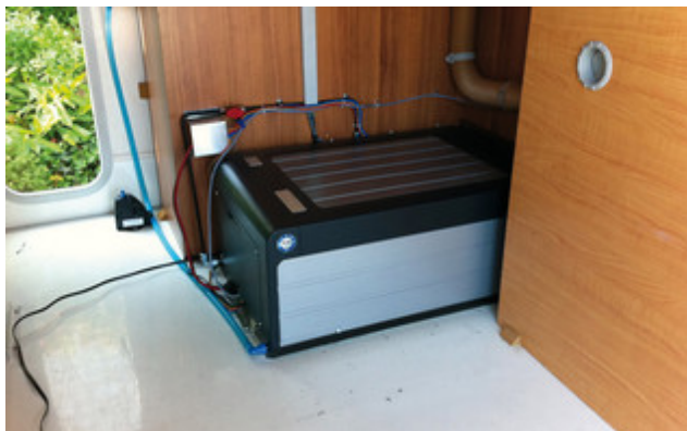
Brennstoffzellen-System in der Heckgarage eines Reisemobils © Truma Gerätetechnik
