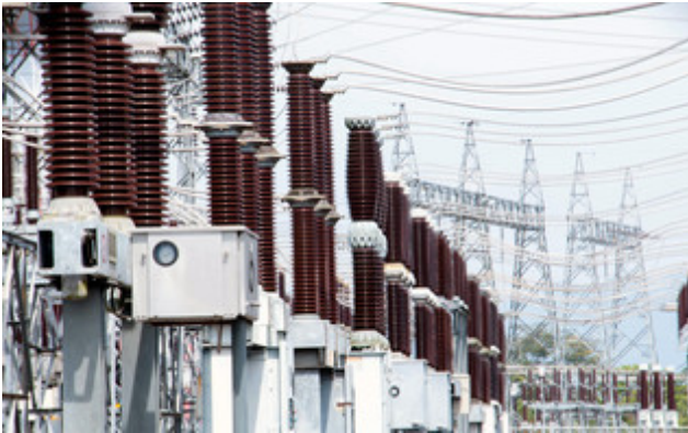
Das Stromnetz benötigt künftig neue technische Lösungen, um die nötige Blindleistung bereitzustellen.
