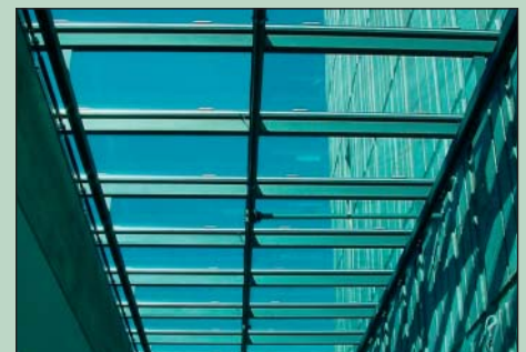
Ein Band mit elektrochromen Verglasungen im ungeschalteten Zustand.
