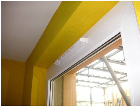
Bild 6: Zuluftelement (Fenster zum Atrium)
