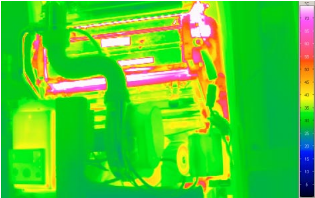
Abb. 27: Detailaufnahme des geöffneten Wärmeerzeugers am 05.03.2003.
