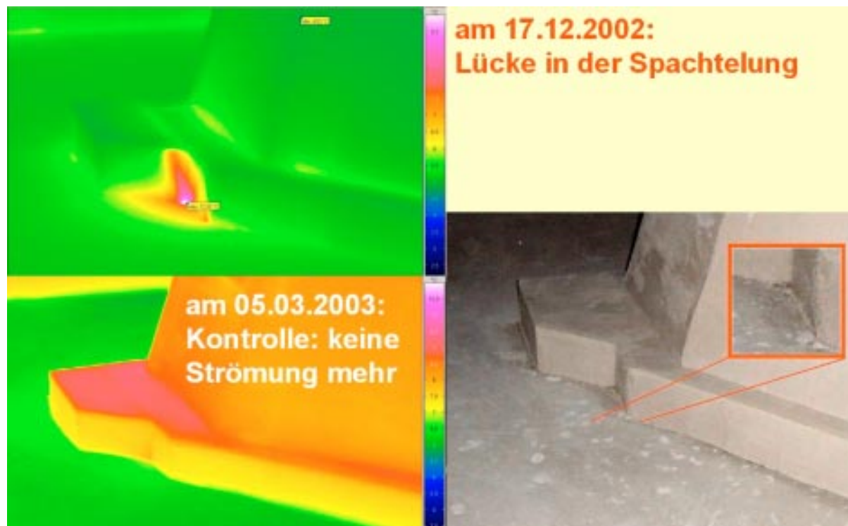
Abb. 18: Dachgeschossdecke nach Fertigstellung inkl. Estrich, Anschluss an eines der alten Kaminbauwerke. Die Thermographieaufnahme oben links zeigt eine Undichtheit, durch welche warme Luft austritt. Die Kontrollaufnahme unten links zeigt, dass nach dem Verguss keine Strömung mehr vorliegt. Weitere Erklärungen im Text.
