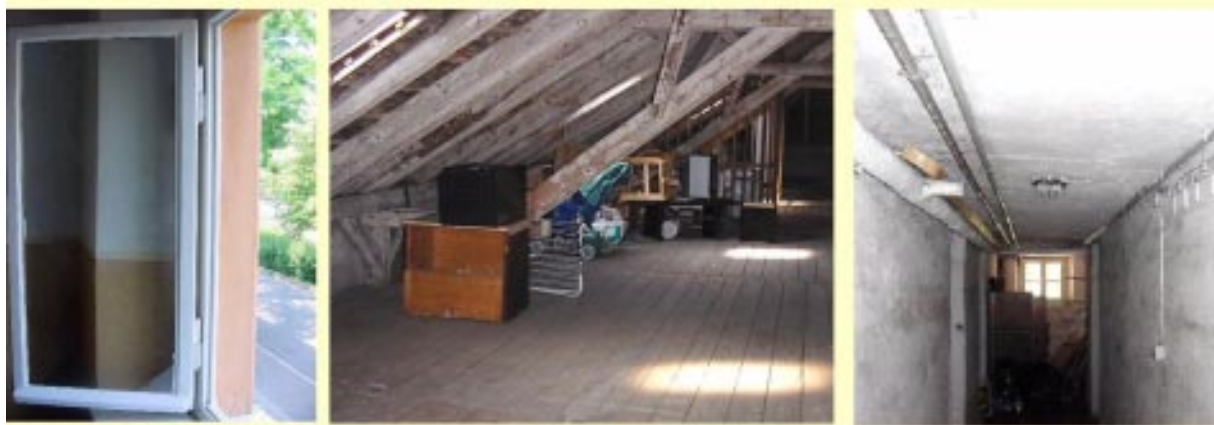
Abb. 15: Holz-Kastenfenster, Dachgeschoss-Holzbalkendecke von oben und verputzte Keller-Rippendecke von unten im ursprünglichen Zustand vor der Modernisierung. Undicht sind vor allem die Fenster und die Holzbalkendecken.
