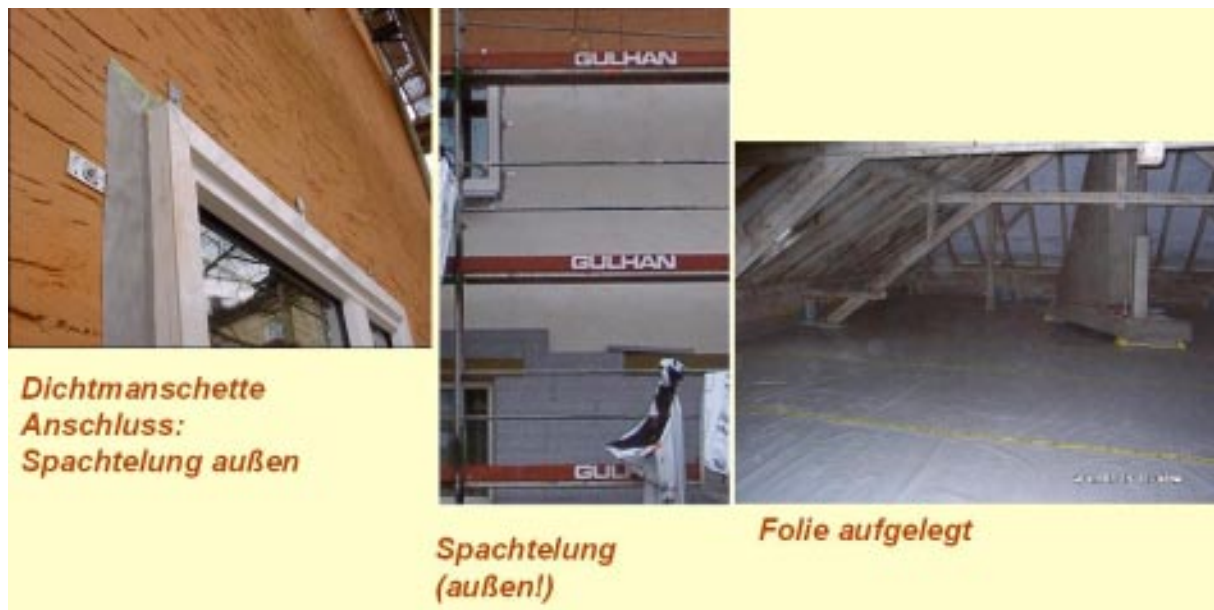
Abb. 15: Maßnahmen, die zur Verbesserung der Luftdichtheit ergriffen wurden: Dichtmanschette am Fenster, Spachtelung in der Ebene des alten Außenputzes und auf die alte Holzdielendecke aufgelegt Dampfsperrfolie (darauf kommt die Geschossdeckendämmung).
