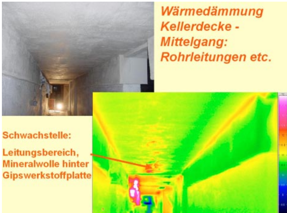
Abb. 14: Optisches und thermographisches Bild der Kellerdeckendämmung im Mittelgang; hier gibt es Schwachstellen wegen der dort unter der Decke verlaufenden Installationen; der "warme Fleck" ist ein Wechselstromzähler, der "kalte Fleck" im Hintergrund ein Kellerfenster.
