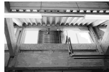
Abb. 7: Der Wärmetauscher der Wärmerückgewinnung in der Dachkonstruktion
