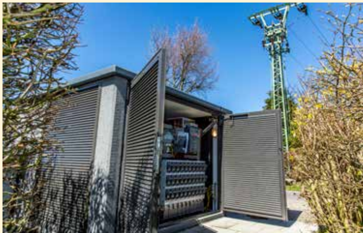
Abb. 1 Kompaktstation mit Fehlererkennung und Spannungsregelung in Simmerath
