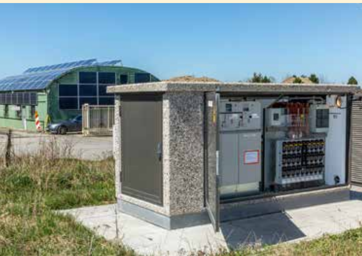
Abb. 4 Regelbare Ortsnetzstationen erhöhen die Netzkapazität für erneuerbare Energien.
