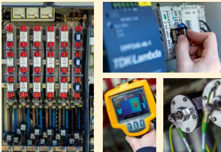
Abb. 2 Innovative Betriebsmittel erfordern neue Kommunikationsinfrastrukturen und Instandhaltungsstrategien.
