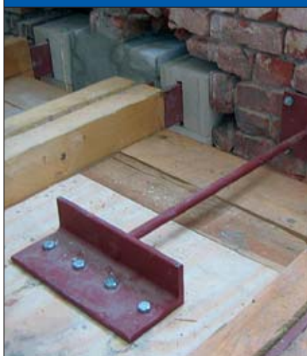
Abb. 7: Die Ansicht zeigt sanierte Balkenköpfe mit Stahlschwert und den Anschluss an die Außenwand mit Zuganker.
