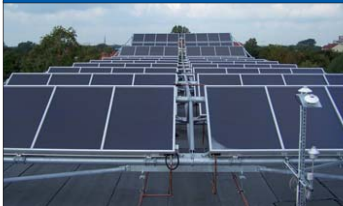
Abb 4: Kollektorfeld auf dem Gebäude Magdeburger Str. 2
