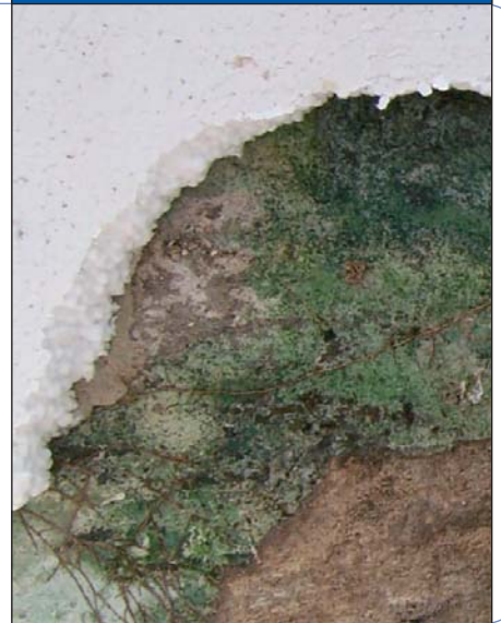
Abb 3: Algenbefall unter der Dämmung aus Styropor
