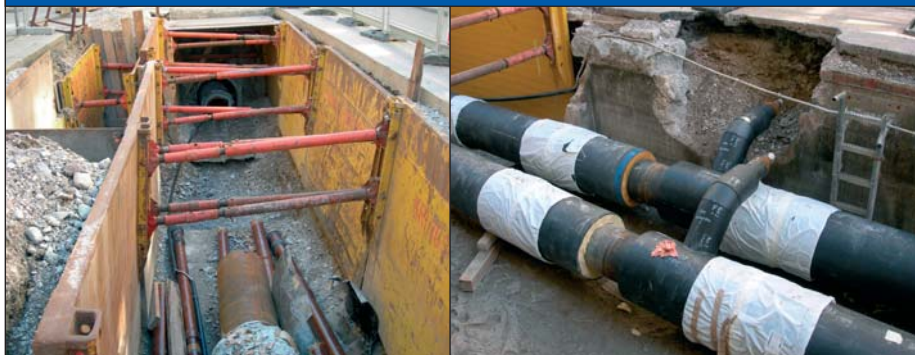
Abb 2: Altersbedingte Sanierungen und Neubauten erfolgen nicht mehr in teurer Haubenkanaltechnik (Bild links), sondern kostengünstiger mit erdverlegten Kunststoffmantelrohren (Bild rechts)
