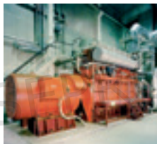
BHKW Modul mit 2.300 kW el
