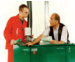
BHKW mit 5 kW el
