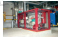
BHKW Modul mit 50 kW el
