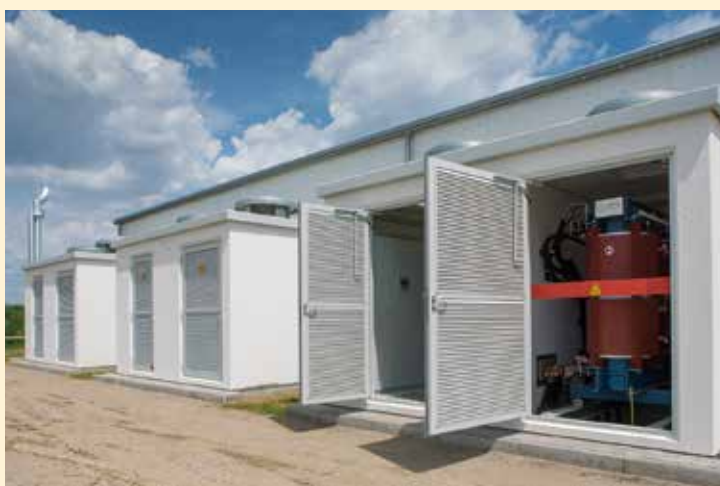
Abb. 2 Drei Gleichstromstationen versorgen jeweils einen PEM-Elektrolyseur.
