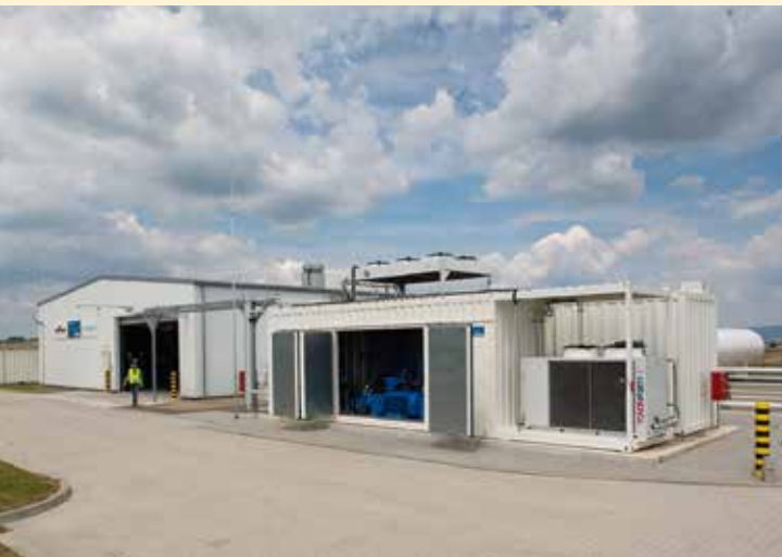
Abb. 4 Der ionische Verdichter ist das Herzstück der Wasserstoff-Konditionierung. Das Aggregat speist mit seinen zwei Stufen sowohl die Speicherbehälter als auch die Trailer.
