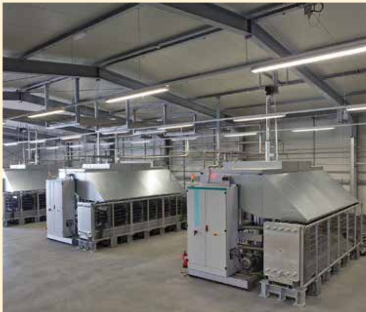
Abb. 1 In der Elektrolysehalle arbeiten drei PEM-Elektrolyseure, die bei einer Maximalleistung von 6 MW 1.000 Normkubikmeter Wasserstoff pro Stunde erzeugen können.
