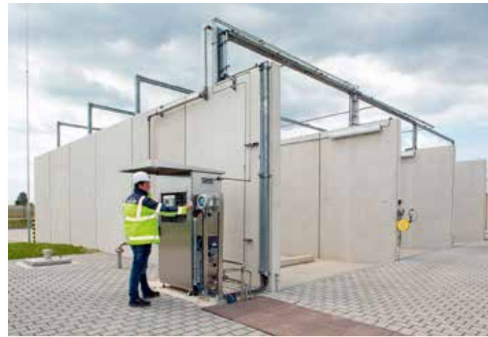
Abb. 5 Abfüllstation für Wasserstofftrailer
