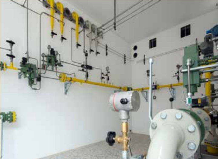
Abb. 3 Einspeisung des produzierten Wasserstoffs in das Erdgasnetz: Die Beimischung erfolgt in eine Sticheitung, die den Stadtteil Mainz-Ebersheim versorgt.
