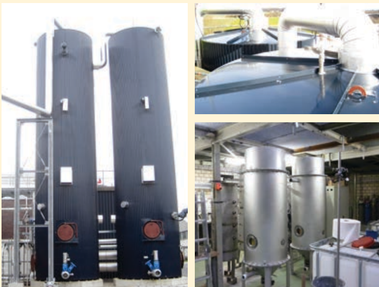
Abb. 5 Die beiden Biofilmfermenter in Gescher sind 12,5 m hoch und verfügen über einen Durchmesser von 3 m. Links und oben rechts: Fermenter in Gescher. Unten rechts: Die Anlage im Labor.
