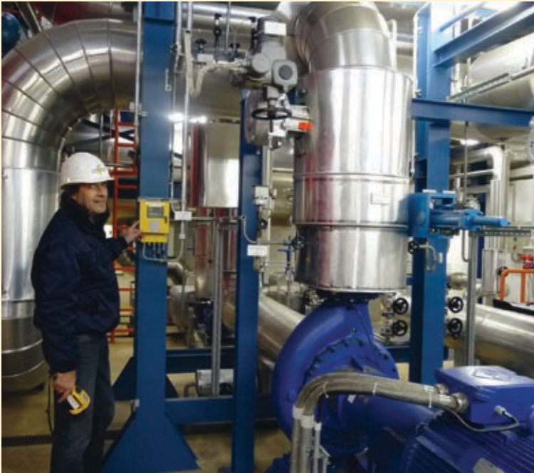
Abb. 3 Im Inneren der Wärmeübertragerstation der Stadtwerke in Jena: Die Anlage überträgt die Wärme von Dampf auf Heißwasser.
