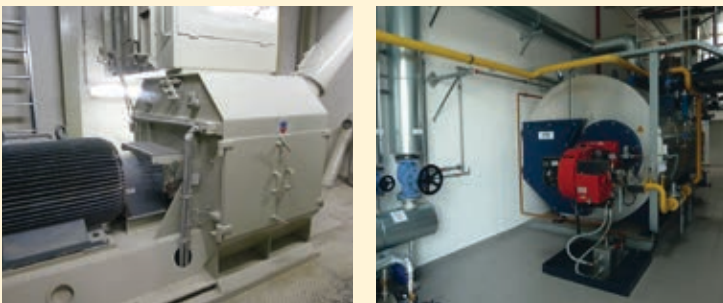
Abb. 5 Hammermühle und Satttdampferzeugung
