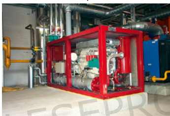
BHKW Modul mit 50\text{ kW}_{\text{el}}
