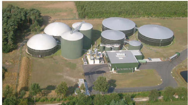
Biogasanlage mit BHKW
