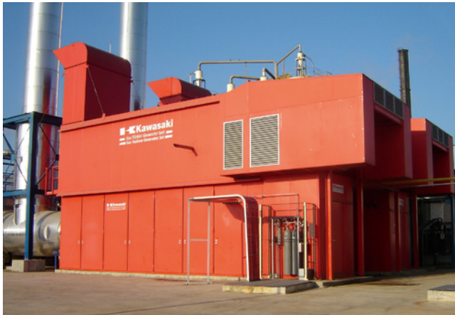
■ Abb. 26: Gasturbine mit 2 \cdot 6,8 \text{ MW}_{\text{el}} und einer Satttdampfleistung von 2 \cdot 15 \text{ t/h}
